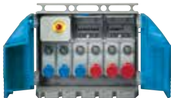
Cuadros de obra ASC con bases enclavadas protegidas con magnetotérmico entrada con clavija 50-60Hz IP65
